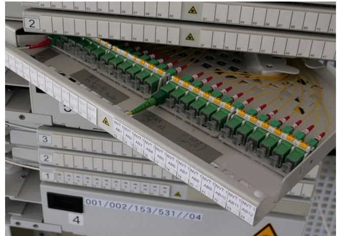
Abb. 11 Beispiel einer konstruktiven Schutzmaßnahme bei einer LWLKS-Steckverbindung in einem Patchfeld. Die Frontblende schützt u. a. gegen Strahlaustritt bei nicht belegten Ports.
